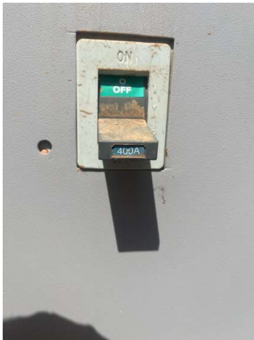
Imagem 06 - Disjuntor Padrão (3x400A)
