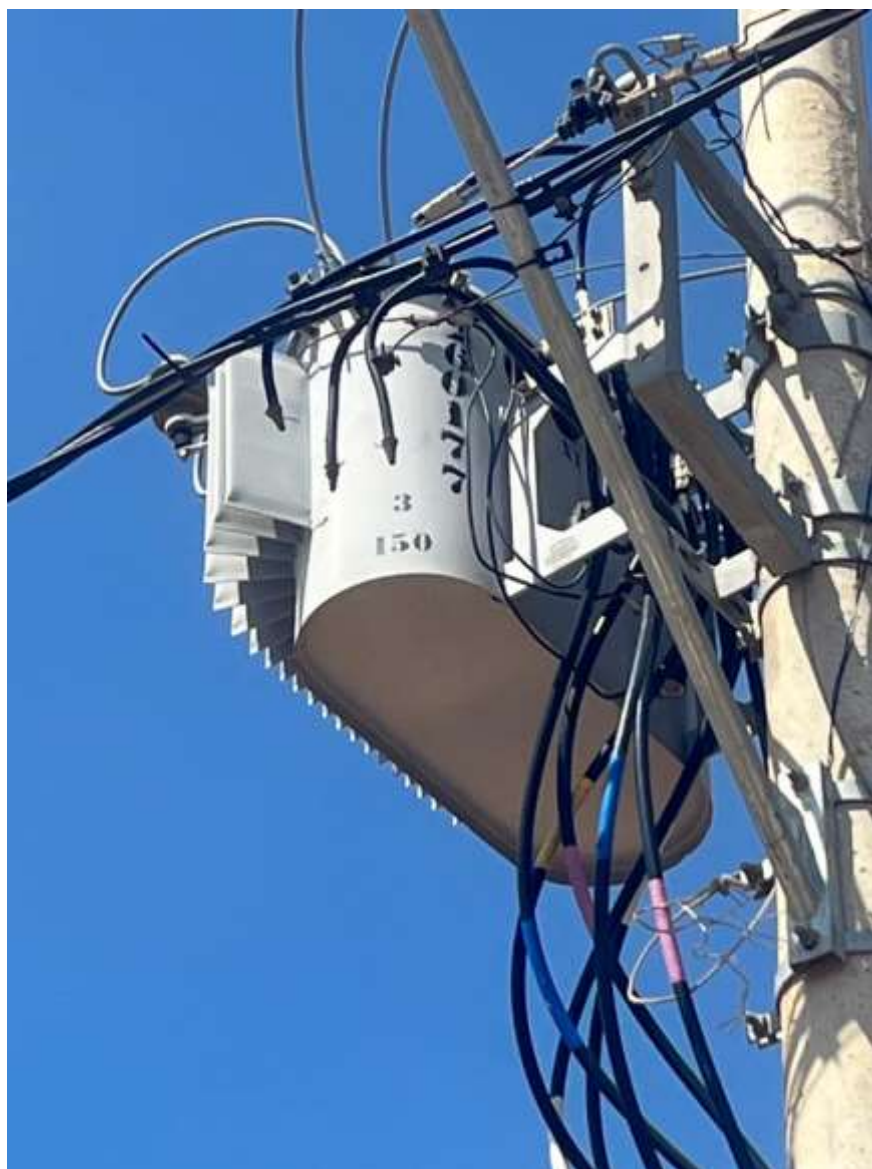
Imagem 07 - Trafo de Derivação (260177-3-150)
