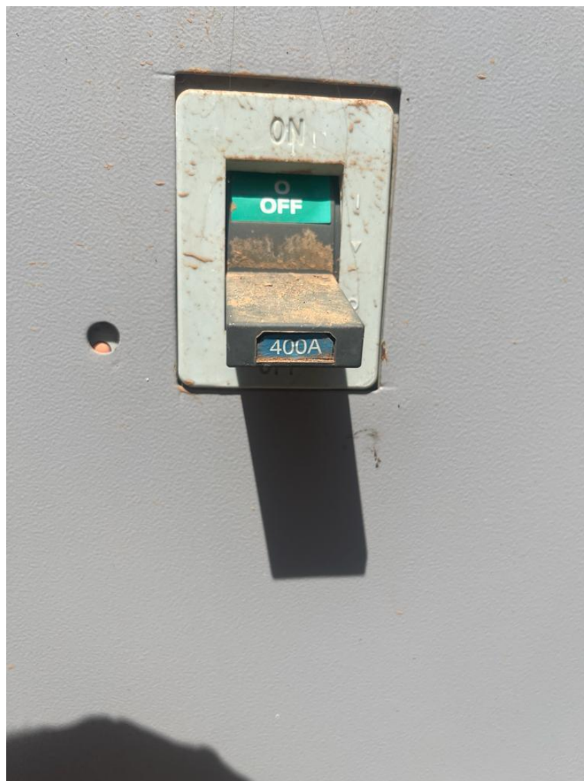
Imagem 06 - Disjuntor Padrão (3x400A)
