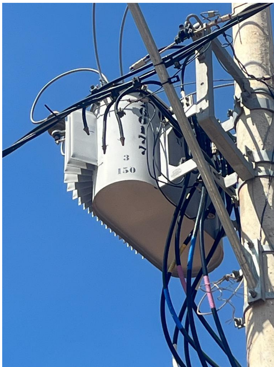
Imagem 07 - Trafo de Derivação (260177-3-150)
