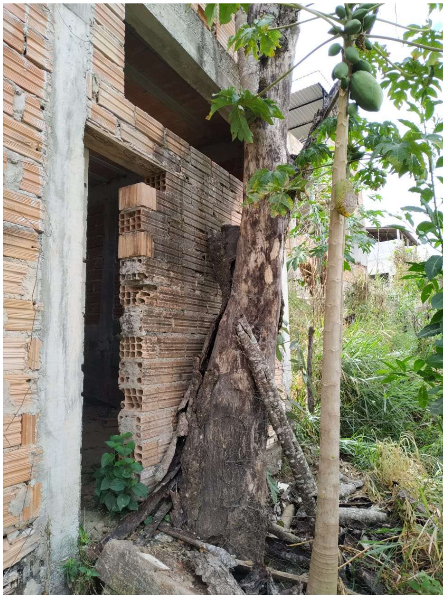
Foto 2 - Vista parcial da aroeira morta.
