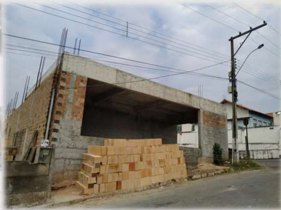
Construção onde se encontrava o antigo "casarão do Nem" - Rua Ferreira Guimarães/Praça Santo Antônio. Autoria: Alexandre de Faria Silva. Registro em 21/09/2020.
